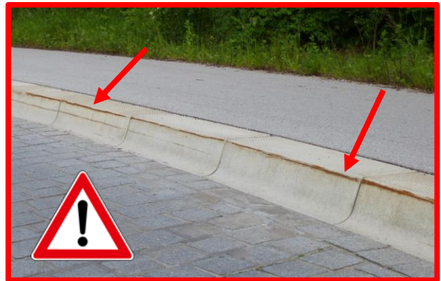
Abb. 12: Aufgrund des bereits im Anfahrtsbereich 18 cm hohen Sonderbords setzt bei nahem, spaltminimierendem Anfahren die Karosserie auf, erkennbar an den braunen Schleifspuren am Bordstein (vgl. Pfeile). Daher müssen immer die Schleppkurve der Busse und der Überhang vor der ersten Achse mitberücksichtigt werden.
