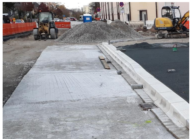
Abb. 19: Haltestelle Wiesenstraße, Fürth Entstehung einer festen, verformungsfreien Fahrschulung durch den Einbau von Betonplatten im Haltestellenbereich im Zuge des barrierefreien Umbaus; anschließend wird die Asphaltenschicht aufgetragen.
