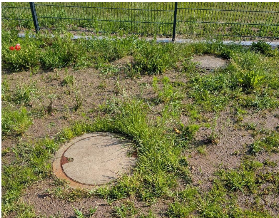
Abbildung 6: Sammelschacht 1 (vorne) und Sammelschacht 2 (hinten)
