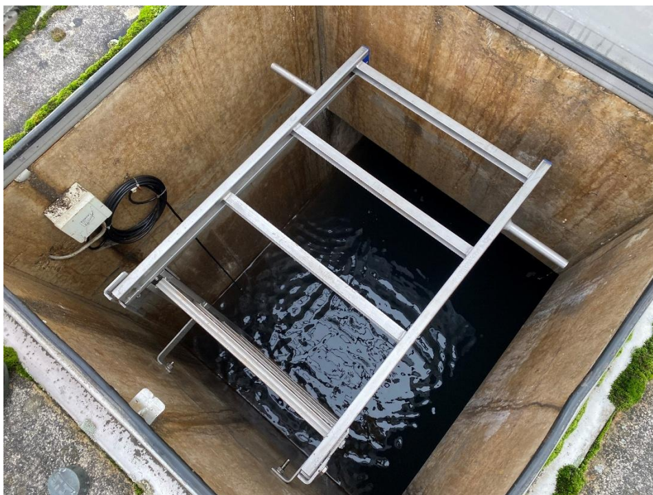
Abbildung 8: Absetzbecken (V = 50 m³)
