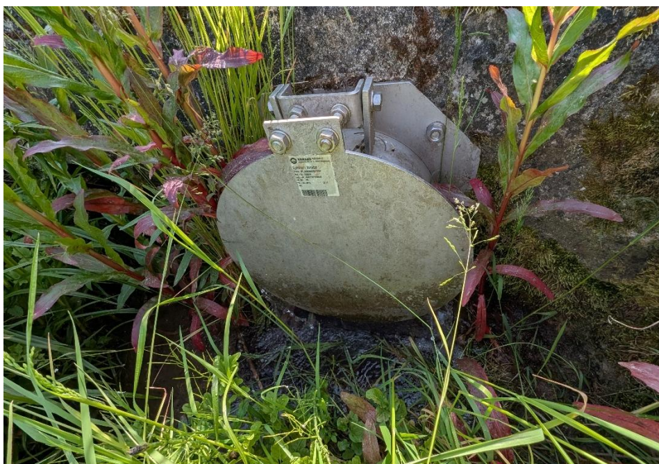
Abbildung 13: Einleitstelle DN 300 Rückstauklappe (vom Absetzbecken kommend)
