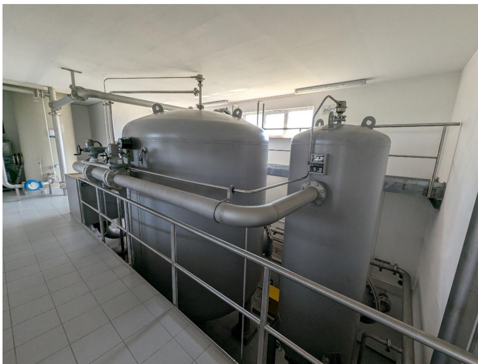
Abbildung 2: Aufbereitungsanlage EG (von links: CO 2 -Rieseler, Kiesfilter, Oxidator)
