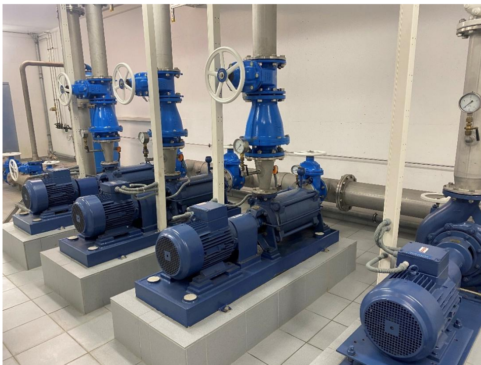
Abbildung 3: Aufbereitungsanlage KG (von links: 3 x Reinwasserpumpen, Spülwasserpumpe)
