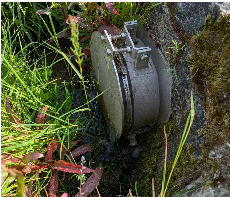
Abbildung 12: Einleitstelle DN 300 Rückstauklappe (vom Absetzbecken kommend)
