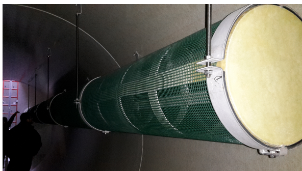
Eingebauter Amiscreen im RÜB 7 Lichtenfels.
