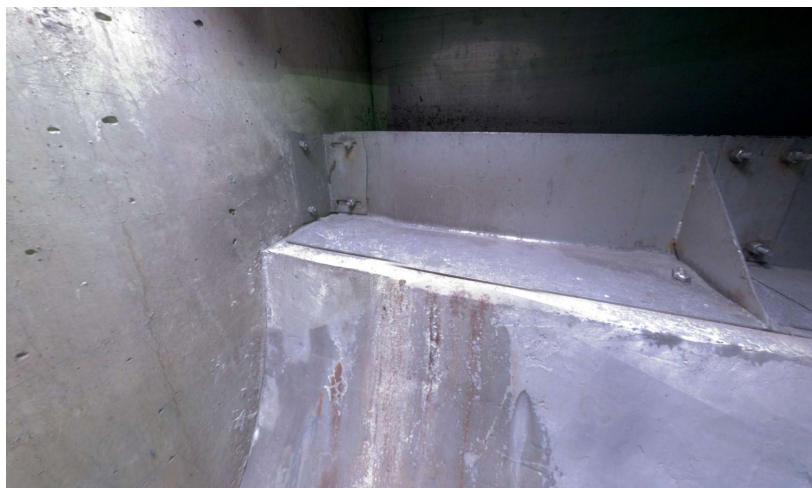
Abbildung 4: Bestand RÜ Untermembach - Aufkantung der Überlaufschwelle
