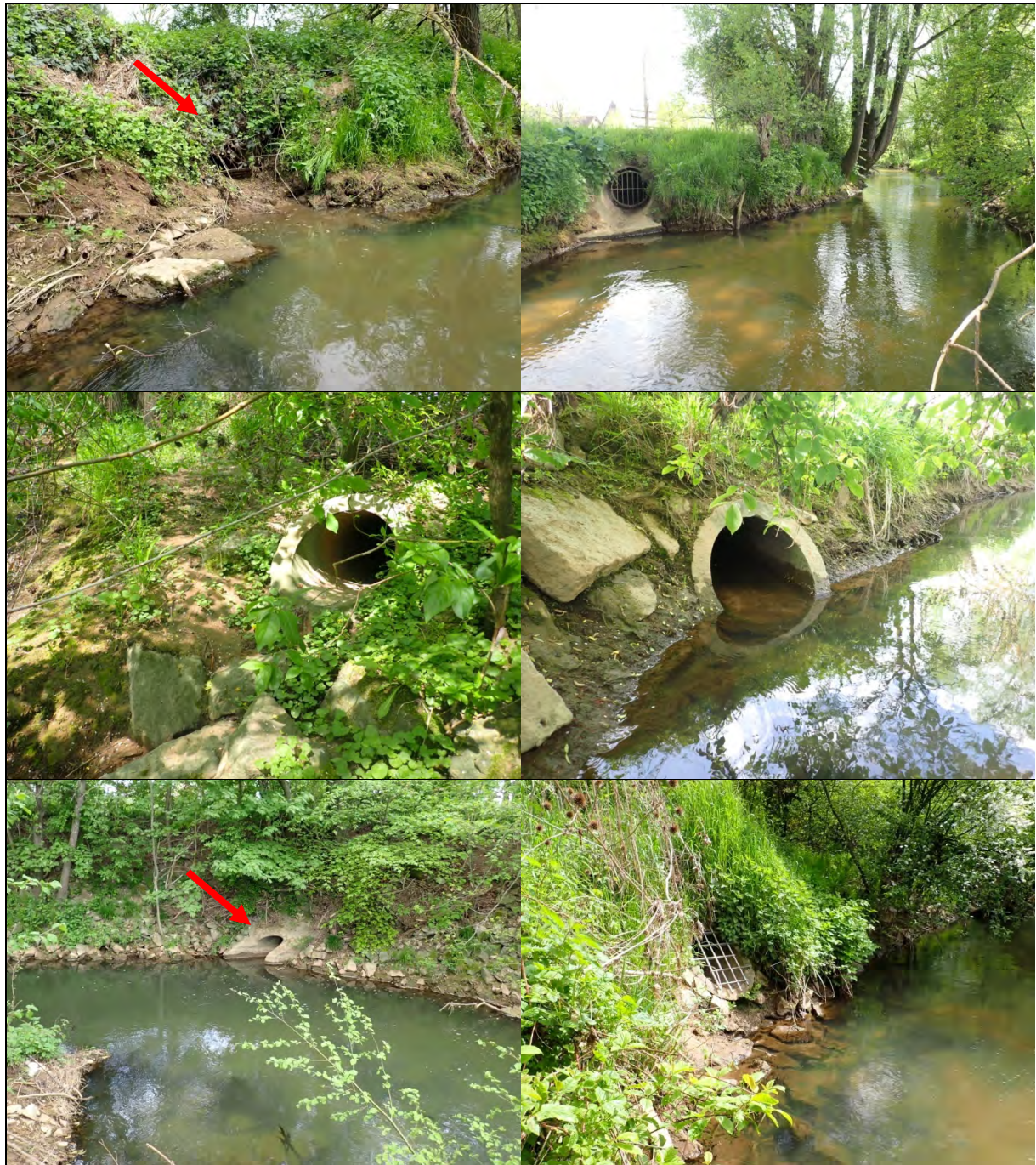
Abb. 58: Einleitbauwerke SKU 20 und SKO 21 (oben links bzw. rechts), SKO 22 und SKU 23 (Mitte links bzw. rechts) sowie SKO 24 und DLB 29 (unten links bzw. rechts) an der Schwabach im Mai 2023.
